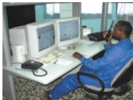
La conduite est désormais centralisée alors qu'elle était auparavant assurée localement, en plusieurs points du site, via des tableaux droits. La communication des "conducteurs" avec les "surveillants" se fait par radio.
